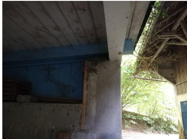
Bachstelzen-Nest in dem westlich des Gebäudekomplexes gelegenen Lager- schuppen.
